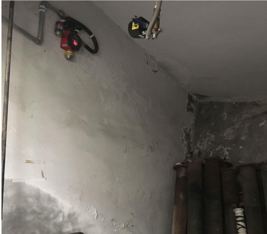
图 8 液氨毒性气体警示仪和喷淋设备
